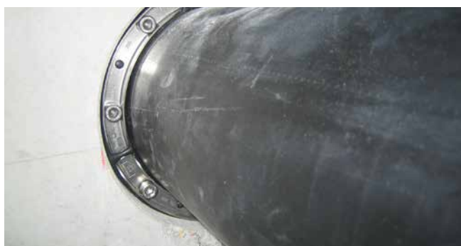
Detailansicht - HSD, Kontrollöffnung und Anzugsreihenfolge der Schrauben
