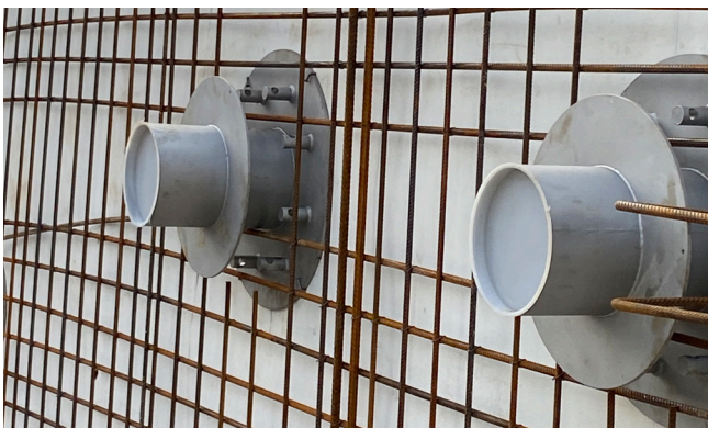
Um eine fachgerechte Anbindung an die Frischbetonverbundfolie zu gewährleisten werden diese bündig auf der Folie montiert.
