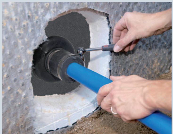
Bild 1 + 2: Wasserhauseinführung MIS 90 (Außen- und Innenansicht)
