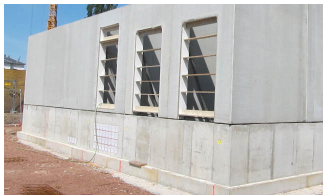
À l'issue du bétonnage de cave sur site, le bâtiment d'exploitation a ensuite été monté sous forme de murs en béton préfabriqués.
