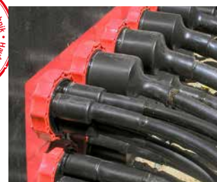
stacja kontenerowa: kable niskiego napięcia uszczelnione za pomocą
