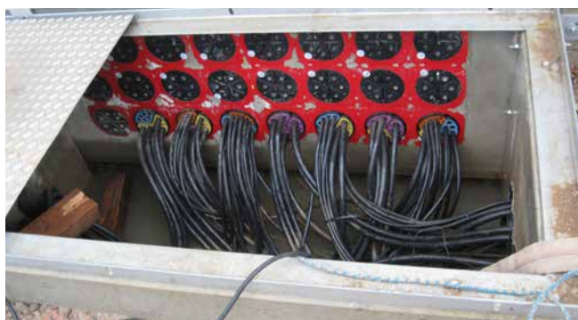
zabetonowane przepusty HSI150 wyposażone w pokrywę systemową SEGMENTO z uszczelnionymi kablami sterowniczymi
