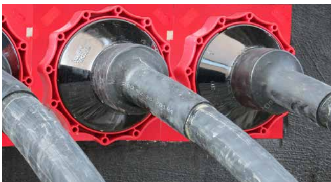
stacja kontenerowa: kable średniego napięcia uszczelnione za pomocą HSI150 D1x80 WS
