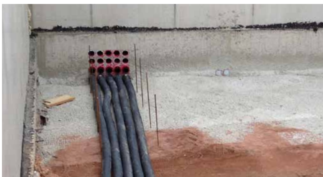
rury karbowane uszczelnione pokrywami systemowymi HSI90 D1x75 KS WR
