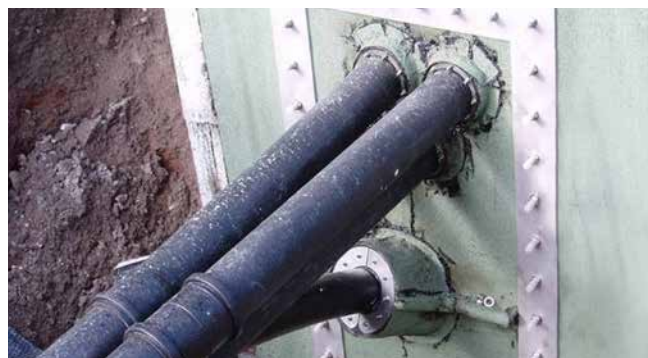
zastosowano flansze stalową oraz gumowe wkłady uszczelniające
