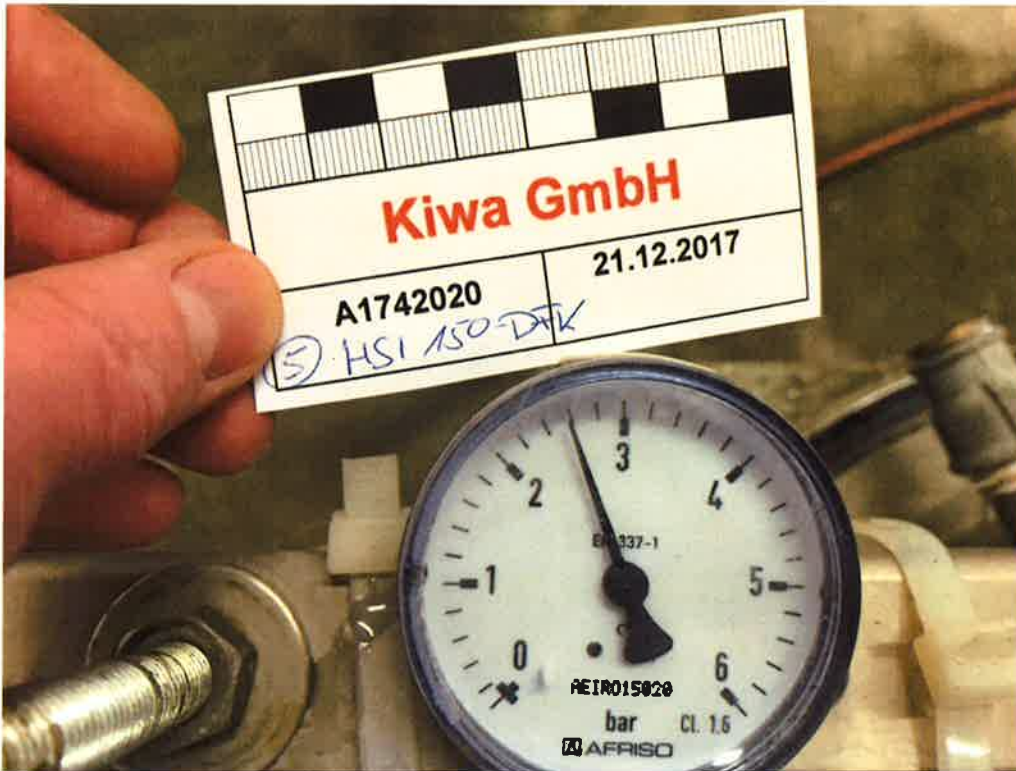
Abbildung A5. Druckdichtigkeitsprüfung der mit wassergefüllten Druckglocke bei einem Nenndruck von \geq 2,5 bar (Manometerstand bei Versuchsbeginn am 21.12.2017).
