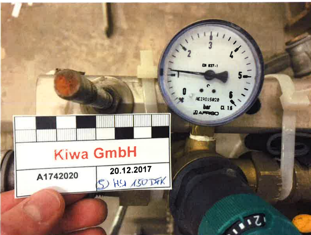
Abbildung A2. Druckdichtigkeitsprüfung der mit wassergefüllten Druckglocke bei einem Nenndruck von \geq 1 bar (Manometerstand nach > 28 Tagen am 20.12.2017).
